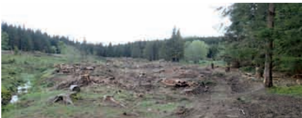
Abattage des épicéas sur les emprises du futur reméandrage du cours d'eau (2018)
